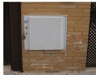
Situación de la Caja General de Protección en muro de fachada
