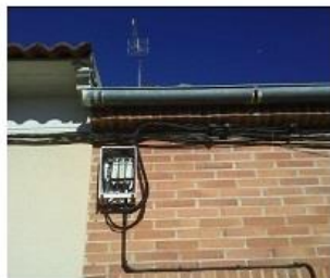
Vista de la Acometida Aérea sobre fachada y Caja General de Protección
