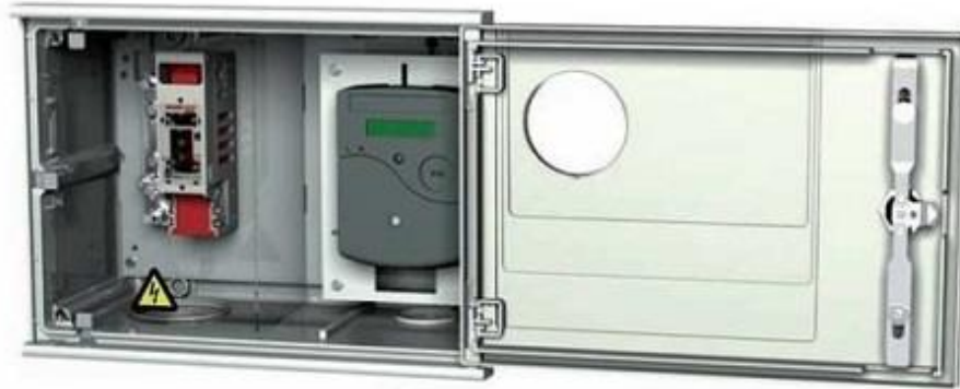
Caja de Protección y Medida (CPM) ( incluye fusibles de protección y contador )
