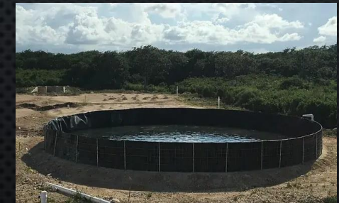
ESTANQUE DE GEOMEMBRANA
