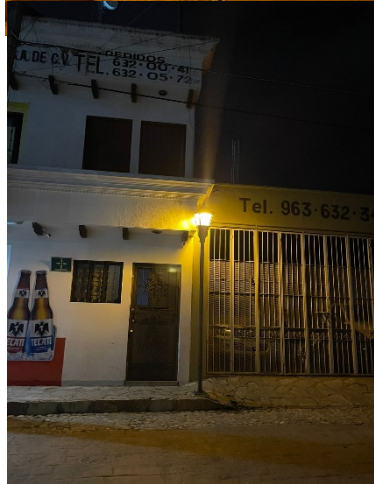
Poste de alumbrado 6 mts cilíndrico 3 plg diam con dado piramidal en piso y luminaria colonial con lampara vapor de sodio 70 watts 220 volts
