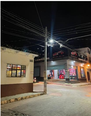
Poste de concreto pcr-11-500 (brinda soporte para la red de distribución eléctrica aérea)
