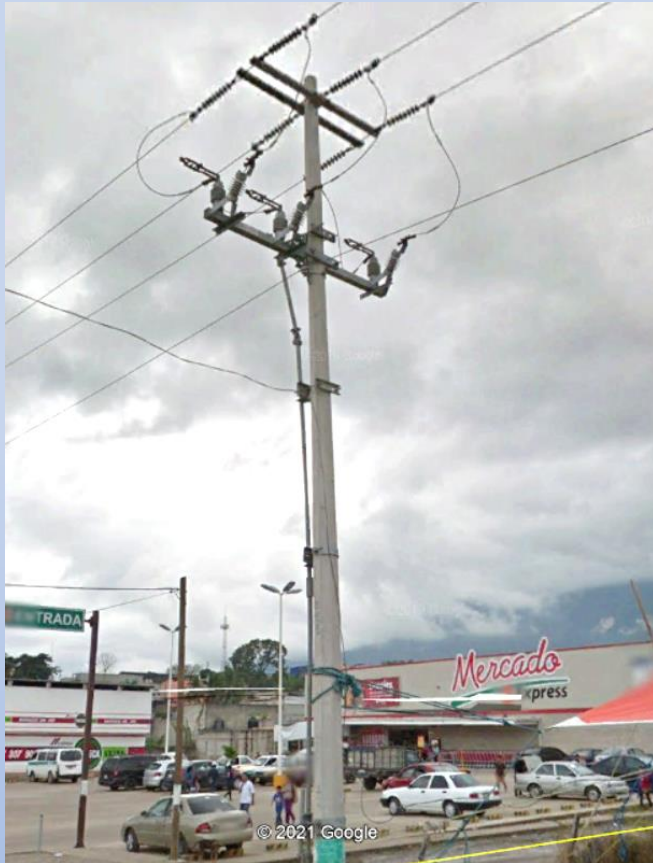
Líneas de distribución
