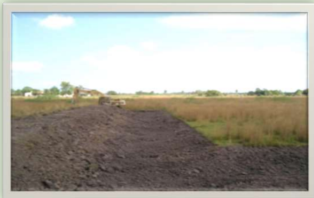
Inicio de la excavación de un estanque piscícola. Nótese el suelo negro característico de alta presencia de materia orgánica.
