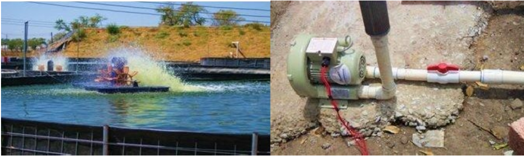
Aireador de paletas, blower e inyector de oxígeno.
