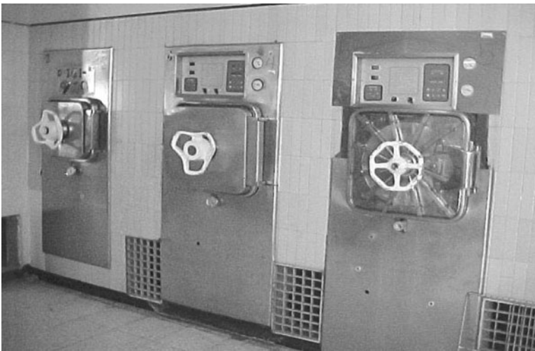
Figura 3-2. Área de esterilización.
