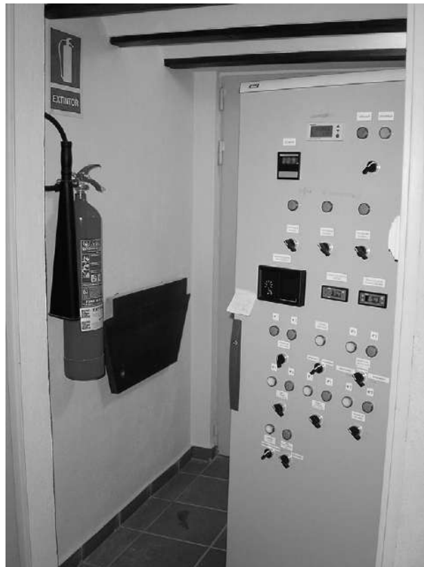
FIGURA 18-3 Extintor de CO 2 situado junto a un cuadro eléctrico.
