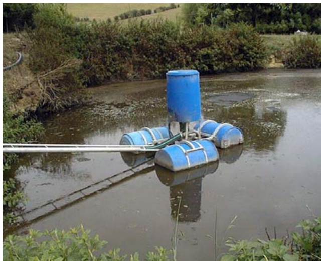
Laguna de sedimentación para sólidos.
