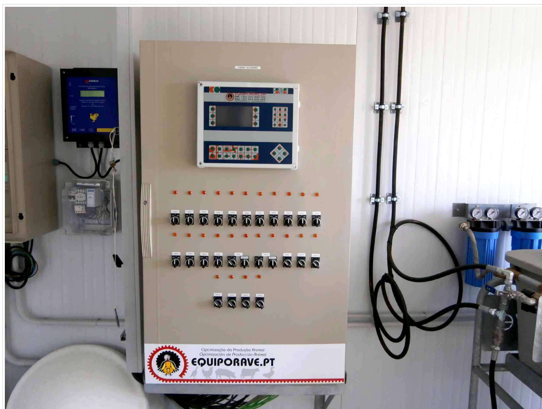
Sistema de control en una granja avícola (granjas-de-pollos.php)
