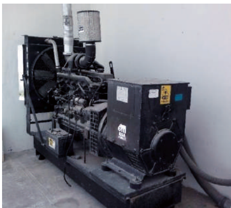
Fotografía 4.6. Planta auxiliar de energía eléctrica.
