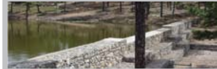
Presa de gaviones
